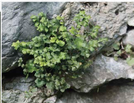
Eine Mauerraute ( Asplenium ruta-muraria ) besiedelt die Stützmauer der Terrasse.
